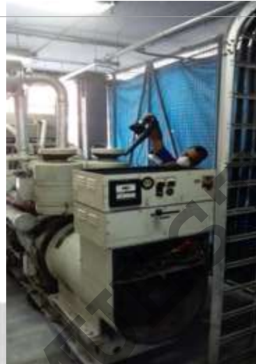
MANTENIMIENTO A PLANTA DE EMERGENCIA
