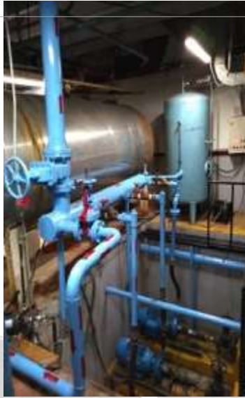
MANTENIMIENTO A SISTEMAS HIDRONEUMÁTICOS
