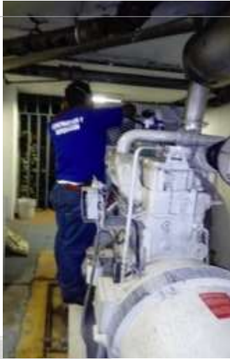
MANTENIMIENTO A PLANTA DE EMERGENCIA
