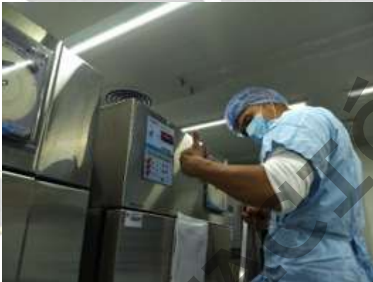
MANTENIMIENTO A SISTEMAS DE REFRIGERACIÓN
